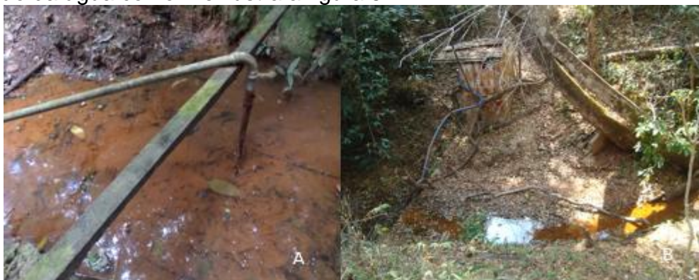
Figura 5 – A) Bomba instalada em nascente. B) Barramento do rio. Fonte: do autor.
